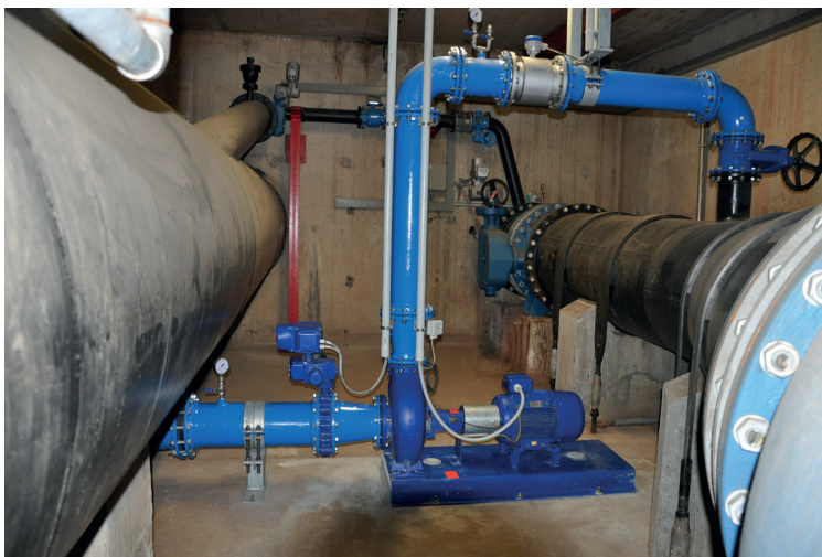
Wasserkraftanlage Staudamm Bostalsee
