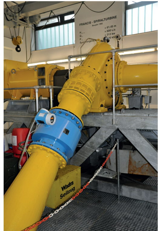
Wasserkraftanlage Primstalsperre Nonnweiler
